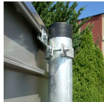
Fot. 1.14. Tablica zamontowana do słupka - widok od strony śruby
